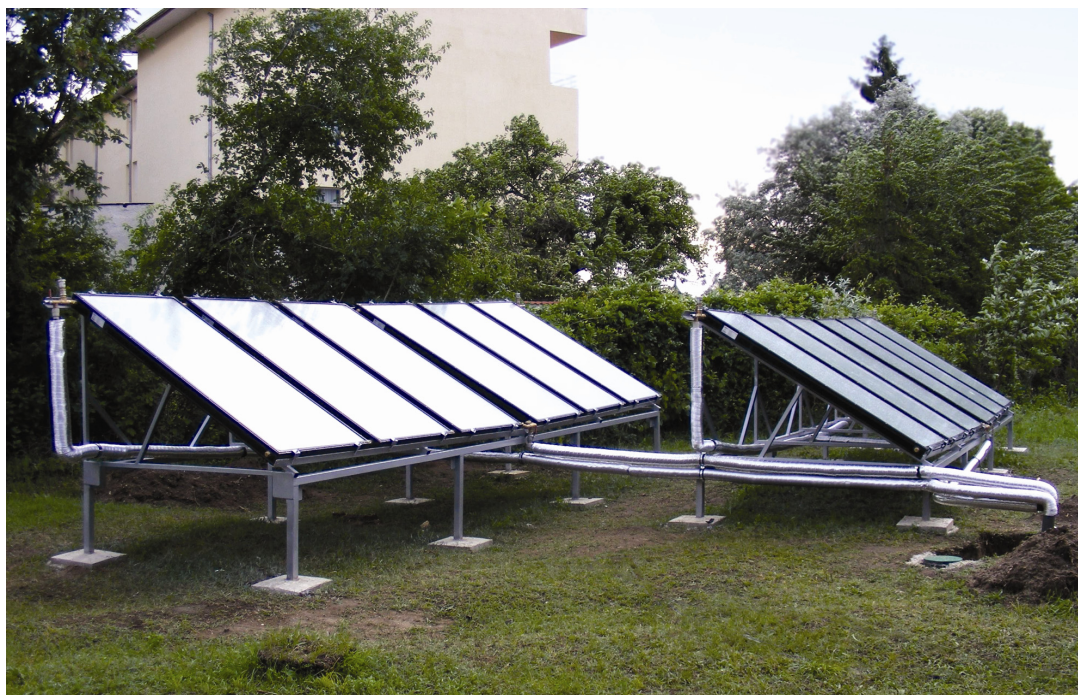
Слънчева инсталация за подгръване на 1500 литра вода за битови нужди на Творчески дом – Варна – БАН
